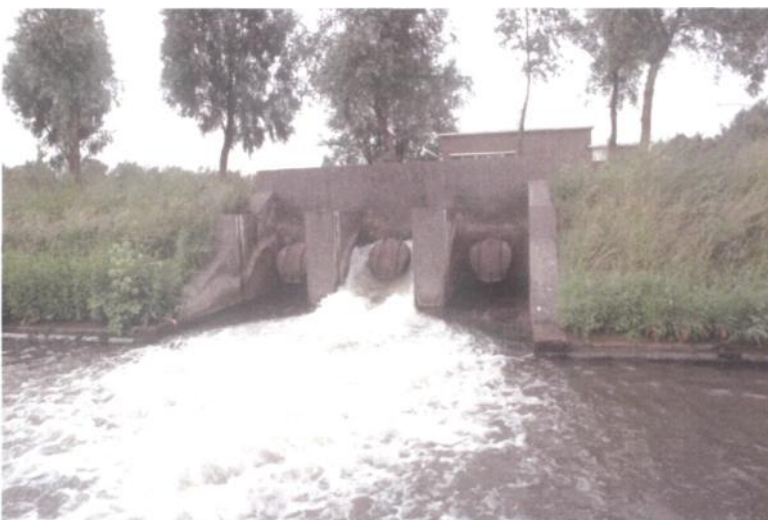
Foto 6. Zicht op de 3 uitlaatkleppen van het pompstation 'Bevere' te Oudenaarde.
