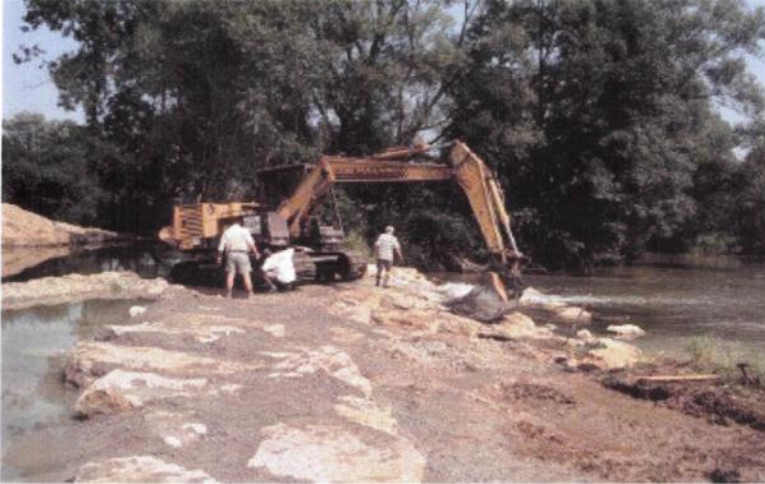
Foto 60. Graafwerken bij de heraanschakeling van een nevengeul in Franse Maas (Foto AERM).
