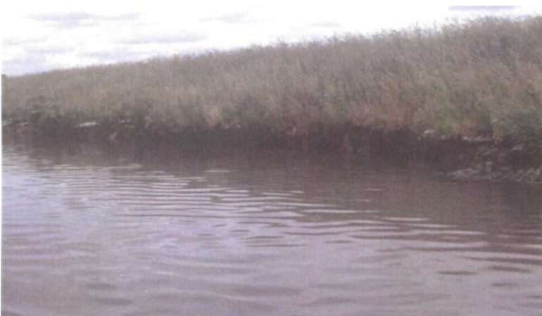
Foto 18. Erosiegaten ter hoogte van oude oeververdedigingen met betonnen golfplaten ter hoogte van Ruien.
