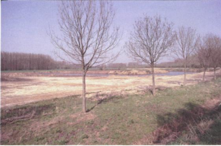
Foto 31. In opdracht van AMINAL-Afd. Natuur werden de steile oevers afgegraven zodat grote ondiepe waterpartijen ontstaan met zeer zachthellende oevers. Dit zal een betere ontwikkeling van oever- en waterplanten mogelijk maken.
