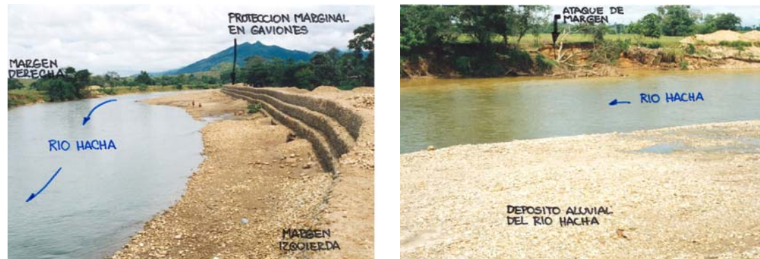
SITIO 1. Vista panorámica y de detalle del sector aguas arriba de la desembocadura de la quebrada La Perdiz en el Río Hacha. Obsérvese la elevación del muro de gaviones (4 niveles) construido para protección de la margen izquierda del río. Margen derecha susceptible a inundación.
