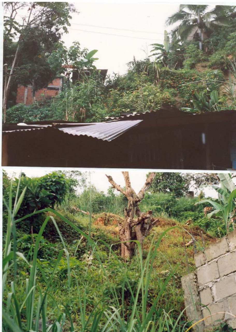
SITIO 10. Vista de detalle de la Quebrada Las Brisas en el cruce de la vía al barrio del mismo nombre. Obsérvese los efectos de la acción erosiva de socavación y de inundación durante las crecidas de esta corriente.
