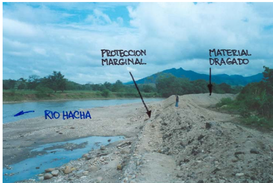
SITIO 1. Vista del Río Hacha curva aguas arriba de la desembocadura de la quebrada La Perdiz. Obsérvese el estado del muro y los materiales de dragado depositados sobre la margen izquierda en la parte posterior de la protección, y en la orilla derecha, nótese el efecto de la erosión y socavación de la corriente en una zona susceptible a las inundaciones
