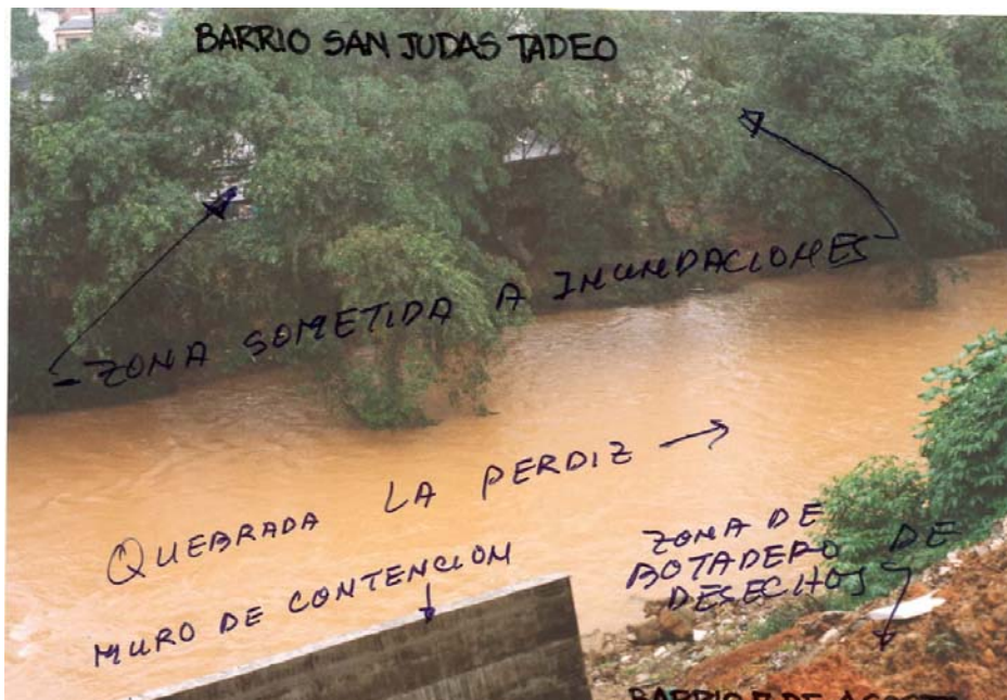
SITIO 5. Vista de detalle del sector del talud inestable en el Barrio 7 de Agosto. Nótese el muro de contención en concreto, construido sobre la margen derecha de la Quebrada La Perdiz para proteger la vía. La diferencia de nivel con la margen izquierda donde se ubica el Barrio San Judas Tadeo es notoria como se observa en la fotografía.
