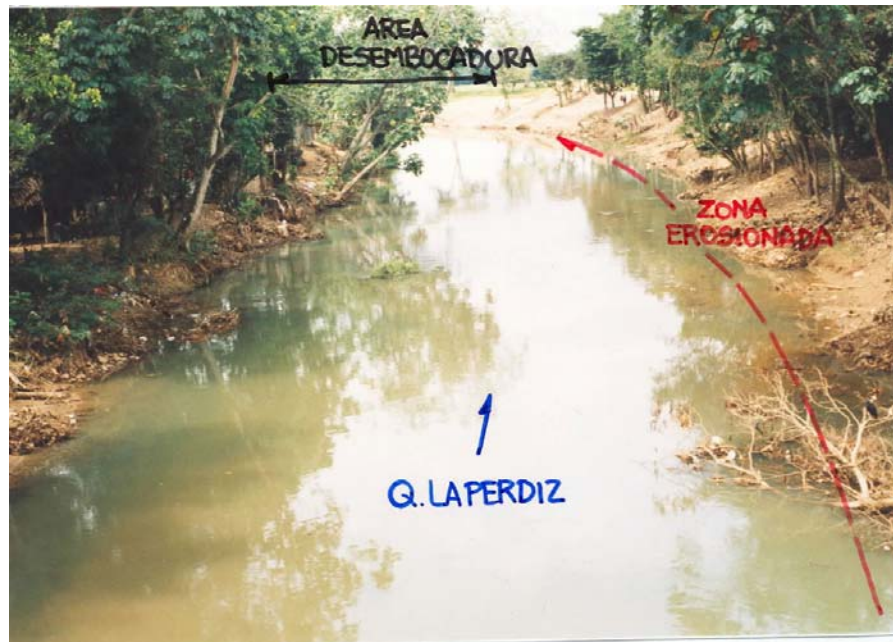
SITIO 2. Vista panorámica aguas abajo desde el puente peatonal Juan XXIII sobre la Quebrada La Perdiz. Obsérvese los efectos de socavación y desbordamiento por la crecida del 14 de junio de 2003, en especial sobre la margen derecha (Zona erosionada)
