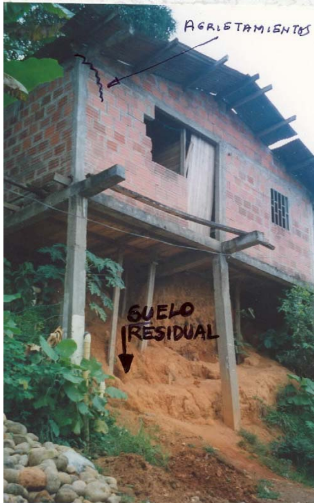
SITIO 4. Vivienda del Barrio Las Brisas, cimentada sobre suelo residual, el cual ha sufrido procesos de inestabilidad que produjeron agrietamientos en la vía, viviendas vecinas, alcantarillado y el talud de la alcantarillado y el talud de la margen hacia el río.
