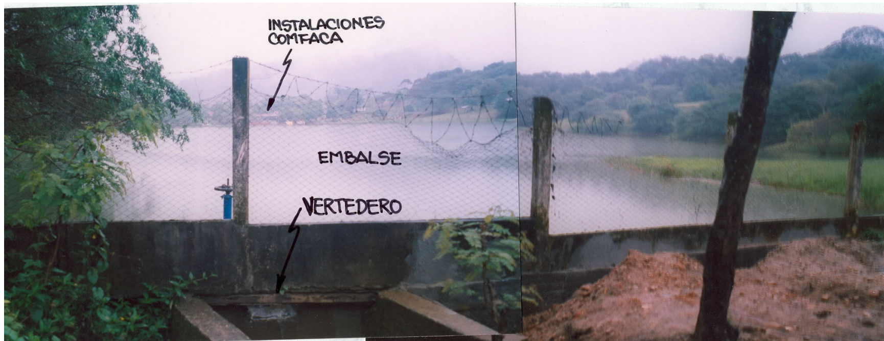
SITIO 11. Vista del embalse en el parque COMFACA – Antigua vía a Neiva. Obsérvese la reciente construcción de la base del enmallado (muro de contención) en altura de 2 m aproximadamente, y el vertedero de excesos del pequeño embalse, los cuales fallaron el pasado 14 de junio de 2003 como efecto de las lluvias de ese día, ocasionando la sumatoria de dicho al caudal de creciente de la Quebrada La Perdiz una vez se produjo el desembalse.
