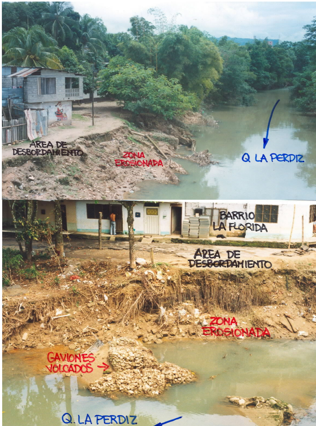
SITIO 2. Vista hacia aguas arriba del puente peatonal Juan XXIII Detalle de la margen derecha de la Quebrada La Perdiz aguas abajo del puente peatonal. Obsérvese los efectos de socavación, erosión e inundación durante la crecida del 14 de junio de 2003.
