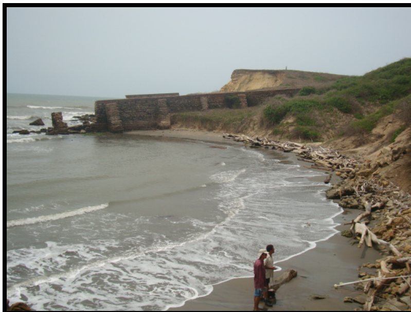
Figura 19. Vista del sector aledaño a El Castillo; nótese como la acción erosiva ha socavado gran parte de los antiguos muros de protección del talud adyacente a la línea de costa.
