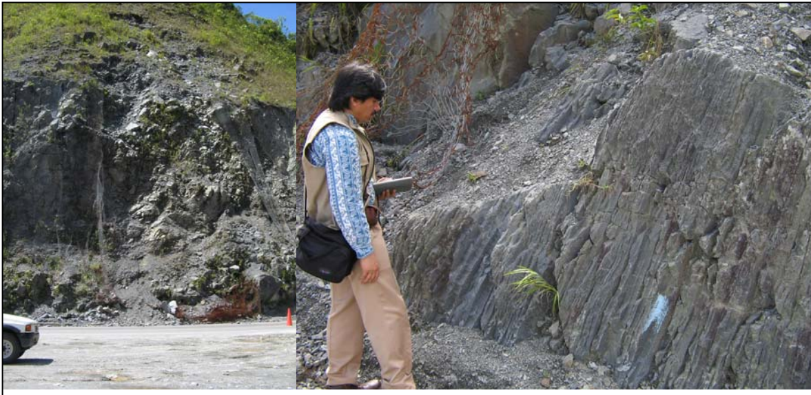
Figura 8. Vista del talud en K 61 + 900. Nótese los planos a favor de la pendiente.
