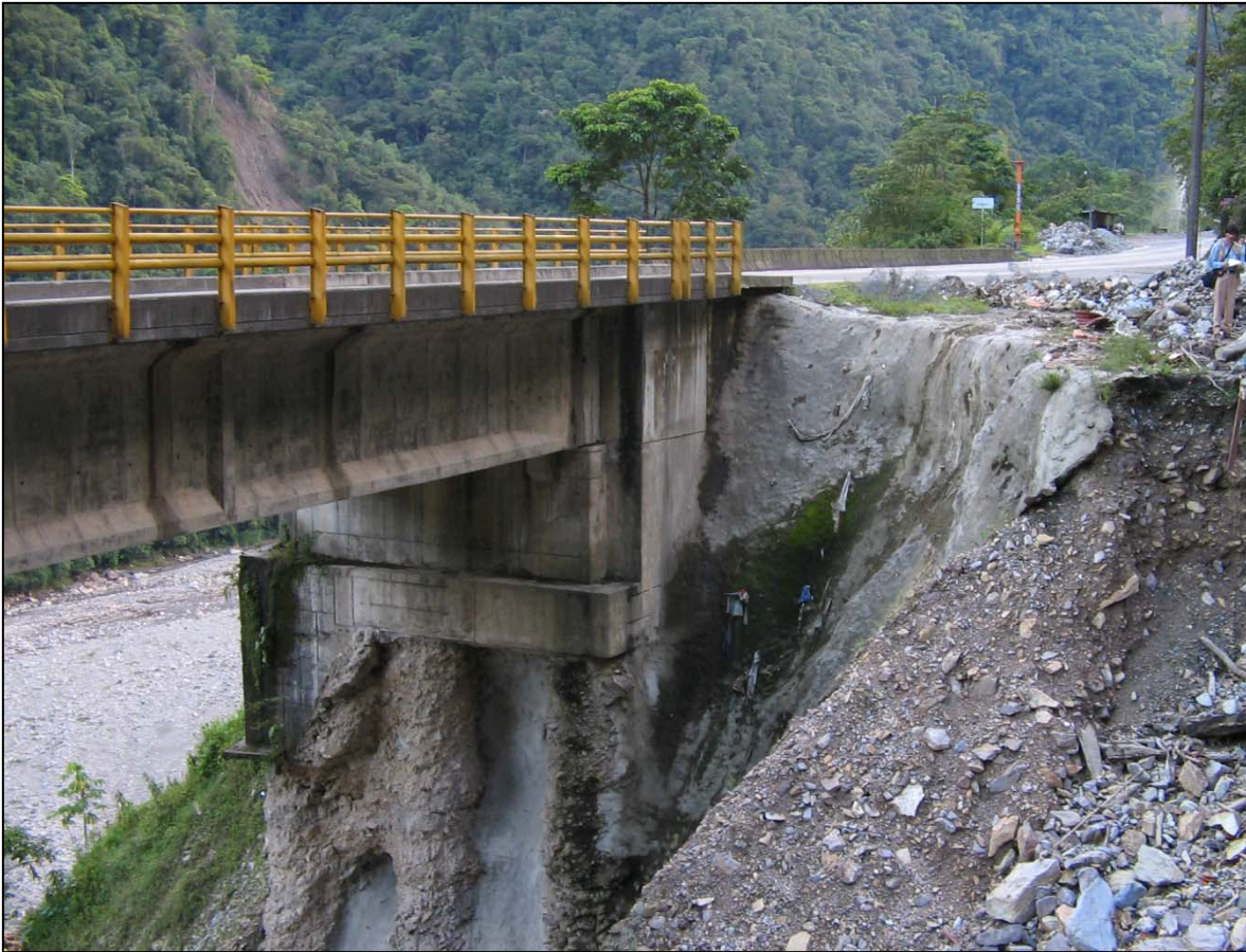
Figura 13. Detalle de los daños ocasionados en el puente por los flujos de escombros en el sector de la quebrada Chigüire. Nótese a la derecha los depósitos de eventos anteriores socavados por los eventos actuales que han dañado la banca de la antigua carretera.
