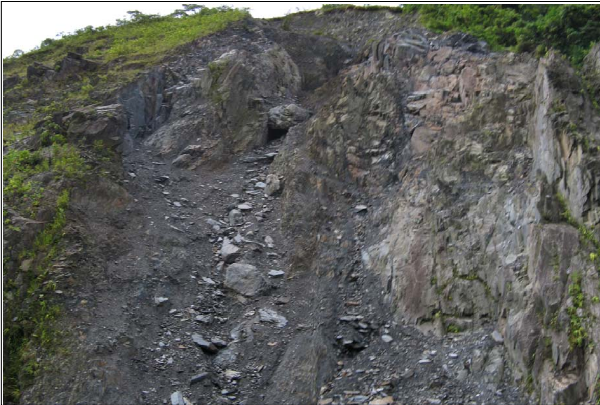
Figura 14. Vista general de la corona de deslizamiento de donde se generó la caída de bloques del km 64 + 200. Nótese la irregularidad de la misma y la disposición de las diaclasas en favor de la pendiente.
