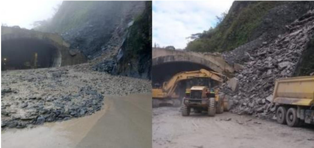
Figura 20. Deslizamiento continuo en Kilómetro 64+200 Vía Bogotá – Villavicencio. Fuente: Coviandes S.A.S año
