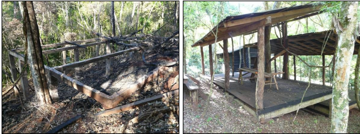
Figura 110: Estructura quemada igual a la del complejo de habitaciones existente.
