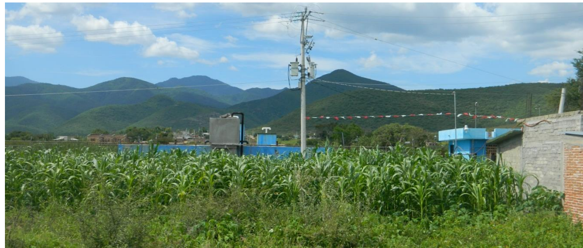
Figura 23. Bomba de extracción en los límites del municipio. Si se extrae más agua de que se puede recargar, las subsidencias en el terreno son muy comunes.
