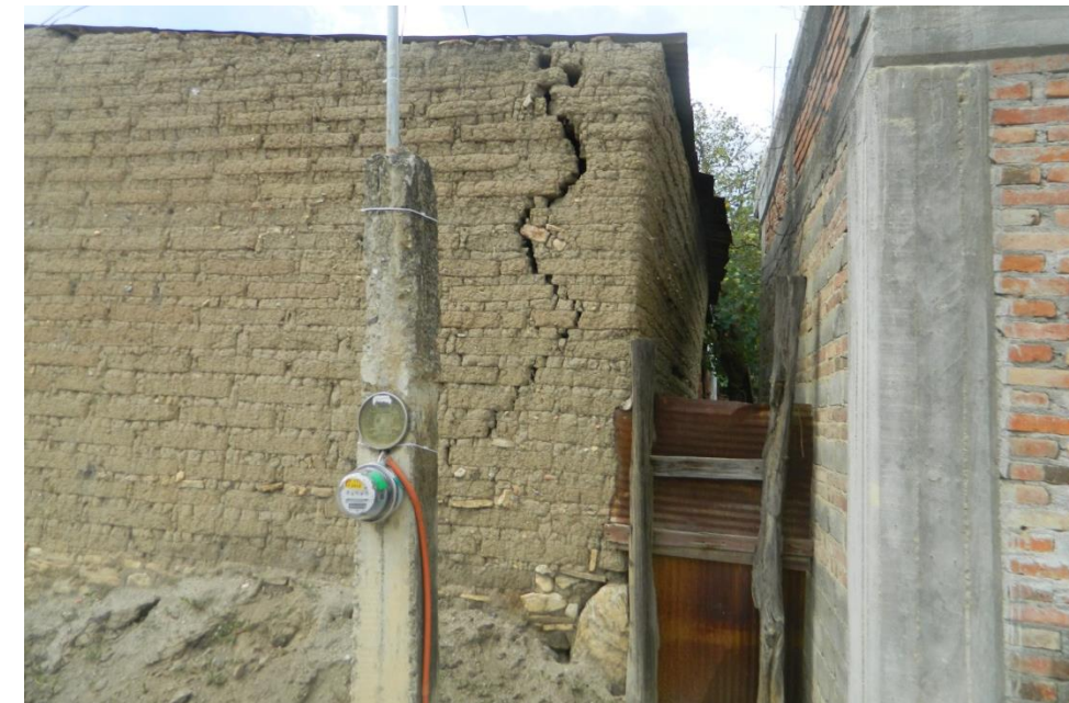
Figura 16. Agrietamiento en construcciones antiguas encontradas alrededor de Santo Domingo Tomaltepec, Oaxaca.
