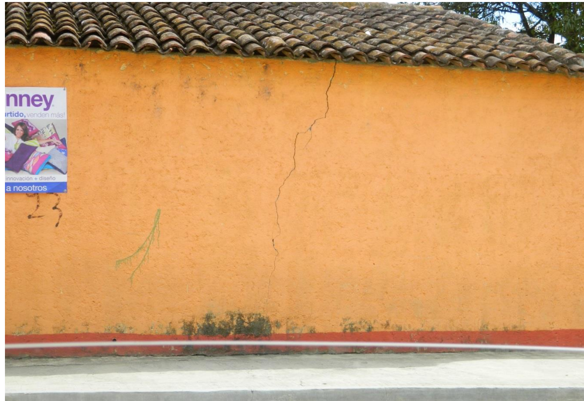
Figura 25. Grieta en casa en el centro de Santo Domingo Tomaltepec, Oaxaca.
