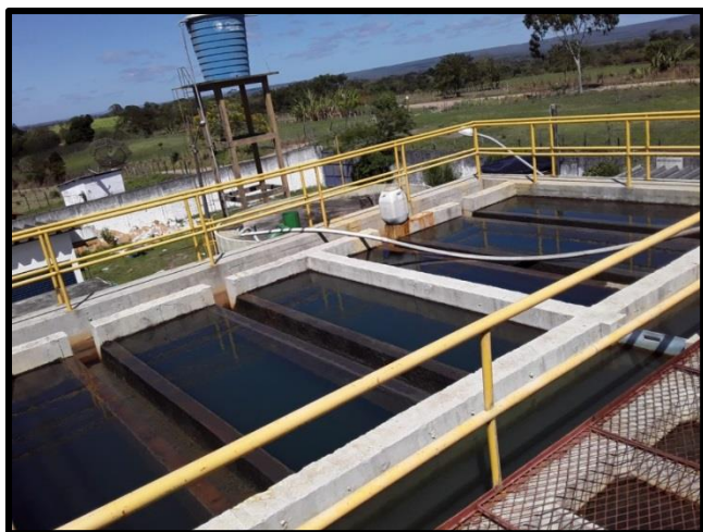
Figuras 14 e 15 – Estação de Tratamento de Água
