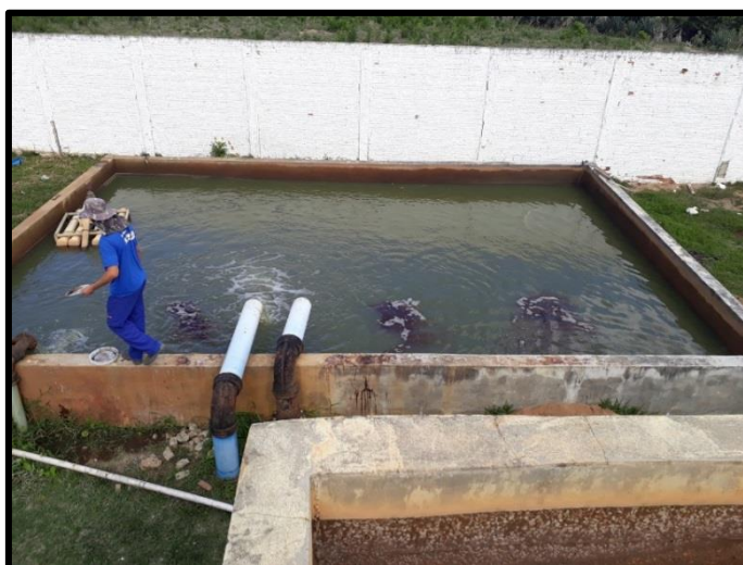
Figura 17 – Lagoa de Reuso – ETA de Tapiramutá
