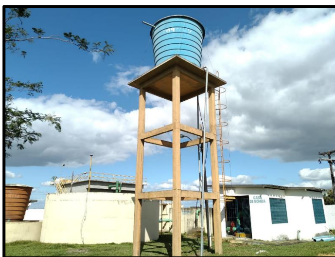
Figuras 16 – Estação Elevatória de Água tratada e reservação – ETA de Tapiramutá
