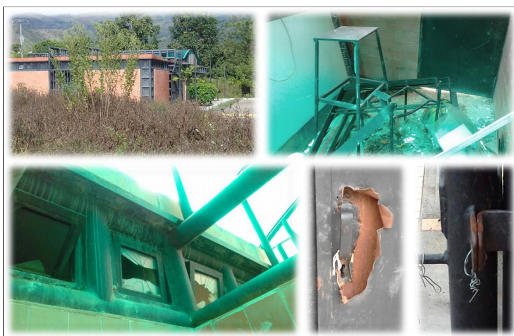
Figura 53. Estado de las instalaciones del Centro de Interpretación del MPAPP, año 2017. Foto: cortesía Miguel Cazorla.
