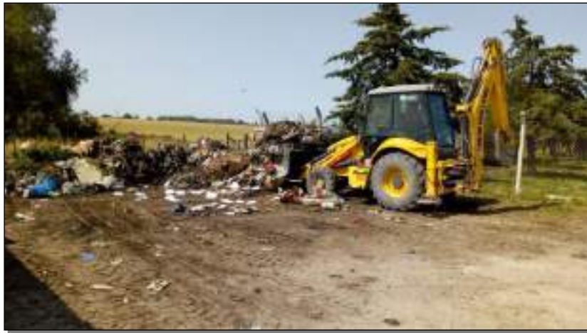
Figura 63: Trabajos para remover micro basural generado en adyacencias de la planta RSU Médanos. Villarino.
