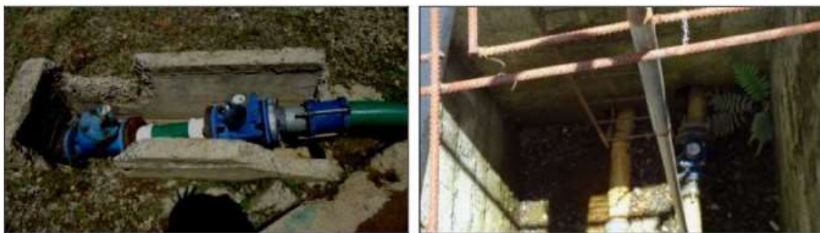
Figura 112. Macromedidores en la PTAP y Tanque de almacenamiento
