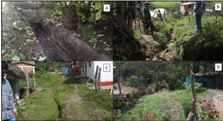
Figura 22. Canales para el control de agua de escorrentía actuales, sector La Gruta y predio Pedro Carvajal. A. Canal con intervención técnica, pero con falta de mantenimiento. B, C y D. Canales artesanales sin ninguna intervención técnica.
