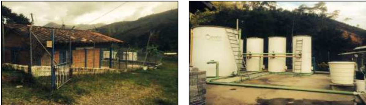
Figura 110. Planta de tratamiento de agua potable, caseta de laboratorio, tanques de sedimentación, floculación y cloración.
