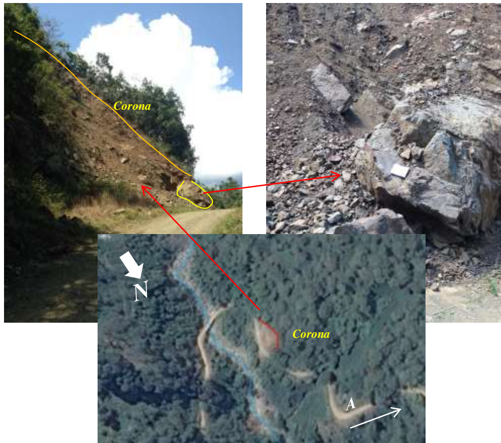
Figura 32. Caída de bloques al borde de la vía a 200m de la quebrada la Soledad.
