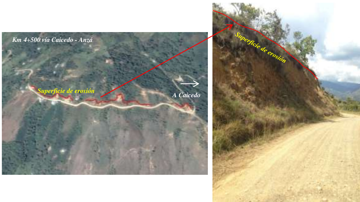
Figura 34. Sector erosivo de 400 m de longitud.
