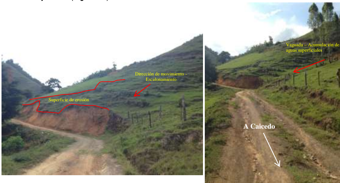
Figura 38. Escalonamiento asociado a desconfinamiento del talud por corte de la vía y sobre carga de aguas superficiales.
