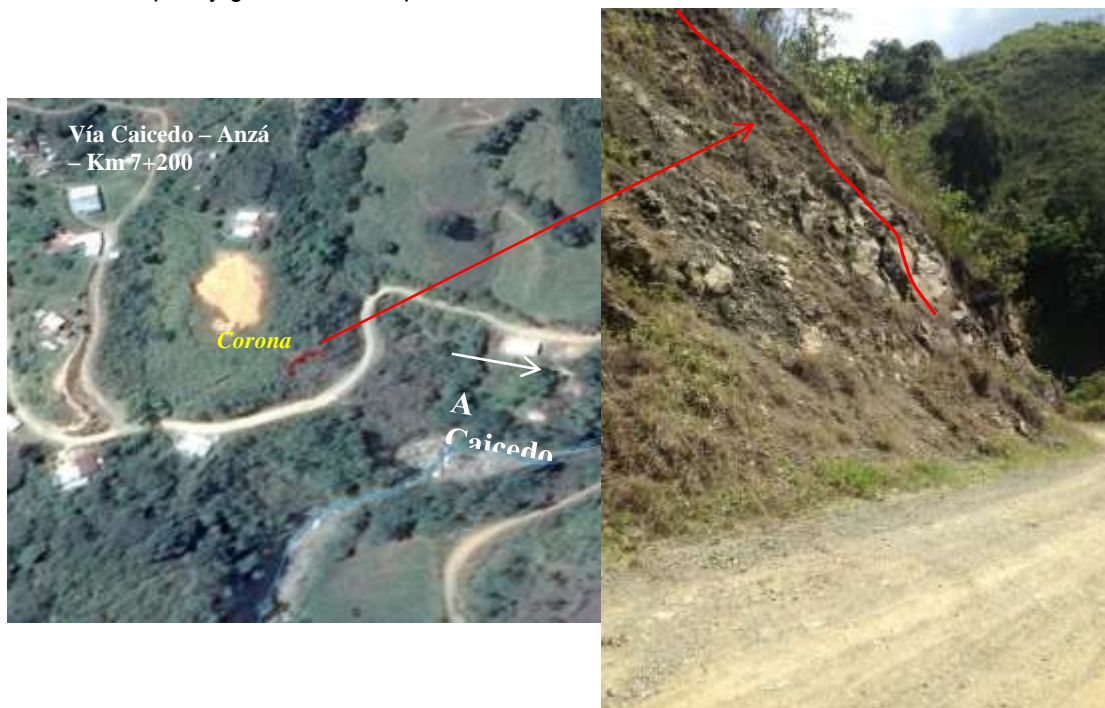
Figura 33. Caída de rocas y detritos kilómetro 7+200 vía Caicedo – Anzá.
