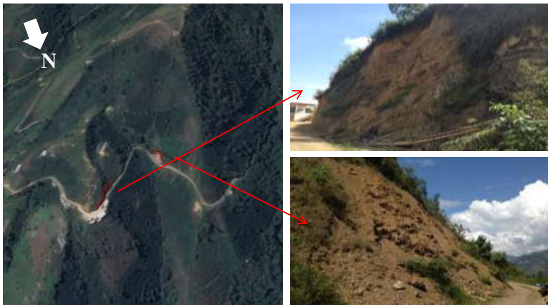
Figura 28. Zonas erosivas con desprendimiento de rocas y detritos, vía Caicedo – Anzá.
