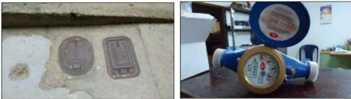
Figura 113. Macromedidores en la PTAP y Tanque de almacenamiento
