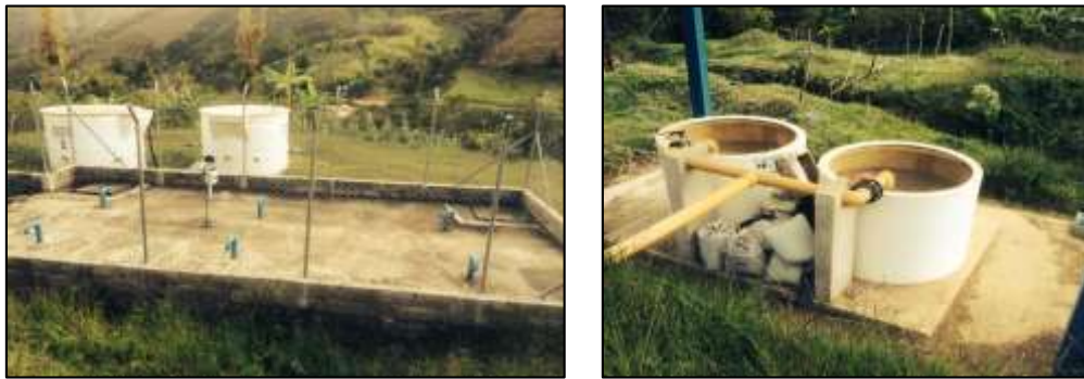
Figura 111. Tanques de almacenamiento en concreto y en fibra de vidrio y lechos de secado de los lodos generados en el proceso de potabilización del agua.
