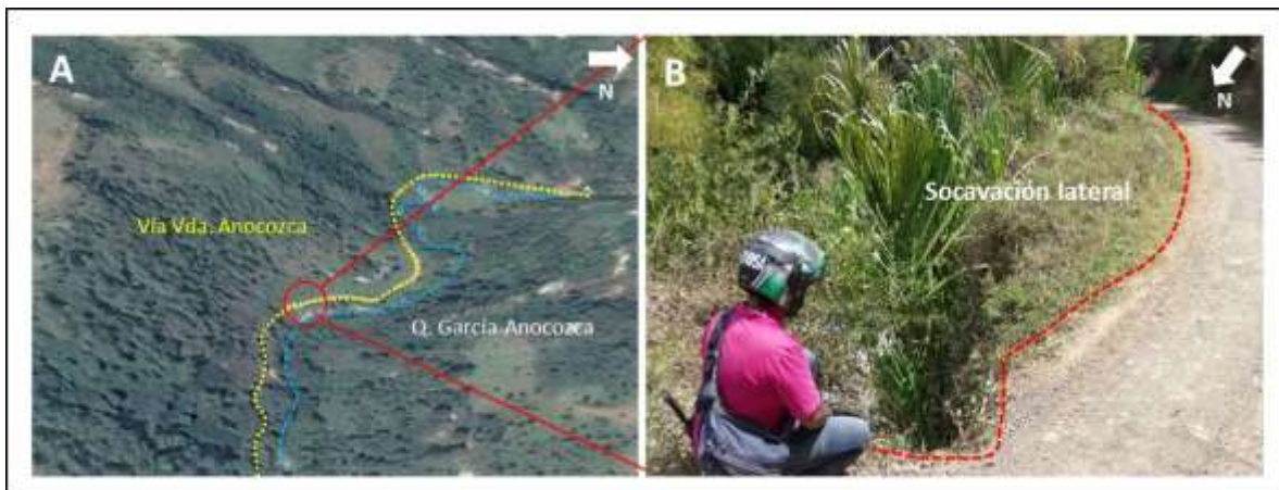
Figura 46. Socavación lateral Vereda Los Pinos. A. Zona afectada. Imagen modificada Google Earth 2015. B. Perdida de la banca en la vía.
