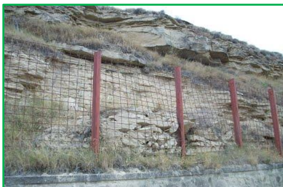
Malla de contención de laderas inestables
