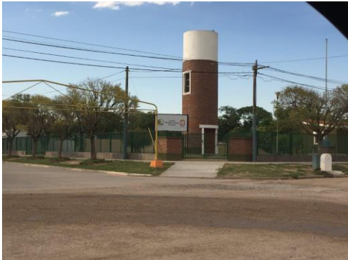
Pozo y planta de agua. FUENTE: Elaboración propia
