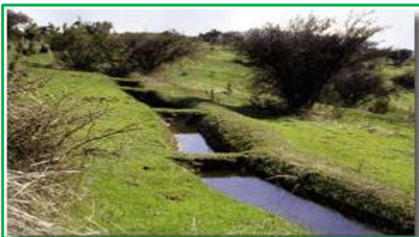
Sistema de drenaje lateral
