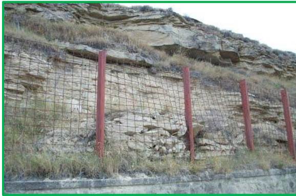
Malla de contención de laderas inestables
