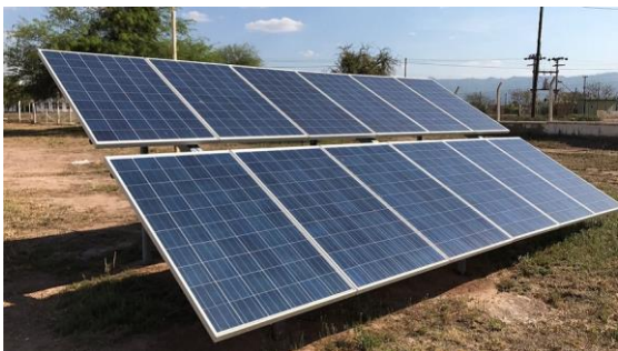
Paneles Solares. Fuente: Chemical – La Rioja
