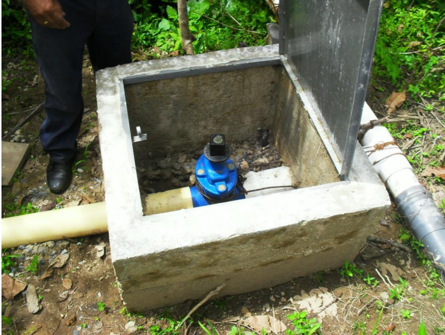
Figura 6. Tipo de válvulas instaladas por consultoría encargada del mantenimiento de la red.
