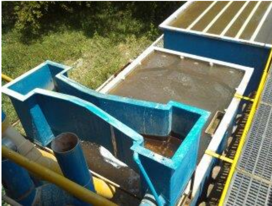
Figura 7. Planta de tratamiento de agua para consumo humano municipio de Togüí- sección compacta convencional.
