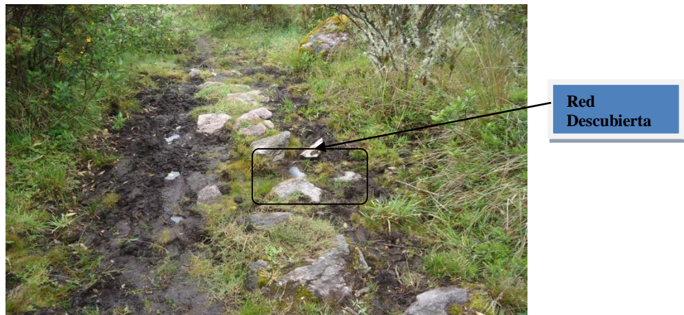
Imagen 19. Red de Conducción sin Protección.
