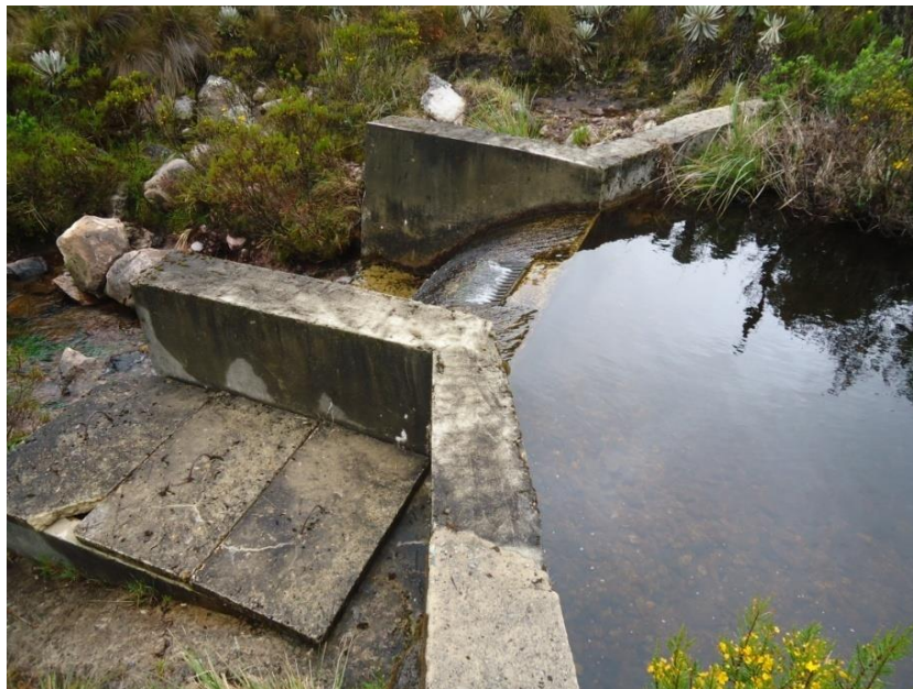
Fuente. Visita de Inspección Ocular
