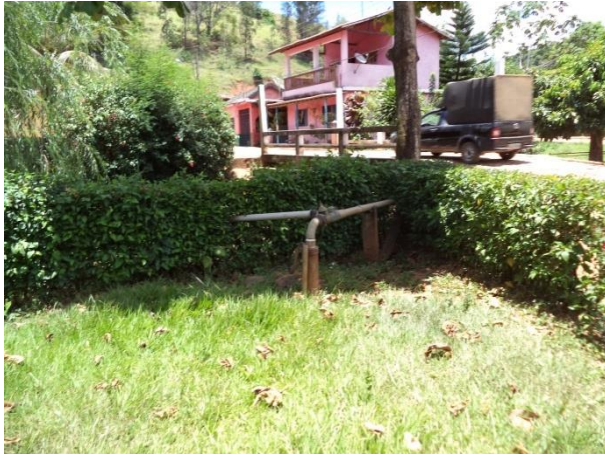
FIGURA 36 – POÇO TUBULAR JURUMIRIM (VISTA 1) (FONTE: VALLENGE, 2014)
