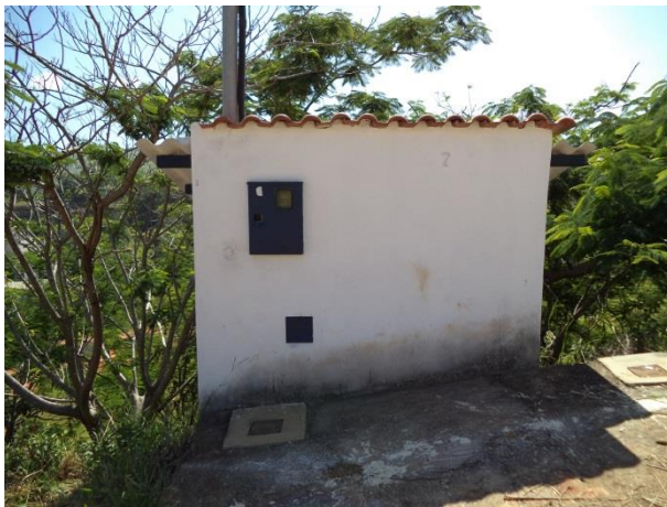
FIGURA 32 – EEAT 3 (VISTA 1) (FONTE: VALLENGE, 2014)
