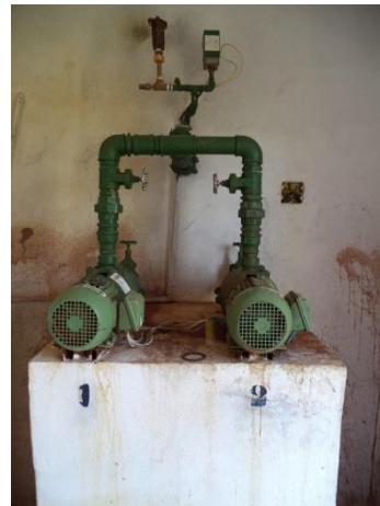
FIGURA 33 – EEAT 3 (VISTA 2)(FONTE: VALLENGE, 2014)
