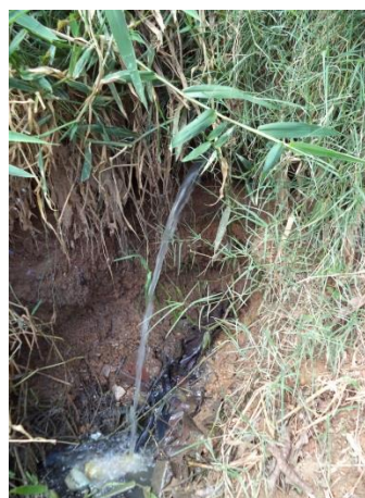
FIGURA 43 – LANÇAMENTO DE ESGOTO VISTA ALEGRE (FONTE: VALLENGE, 2014)
