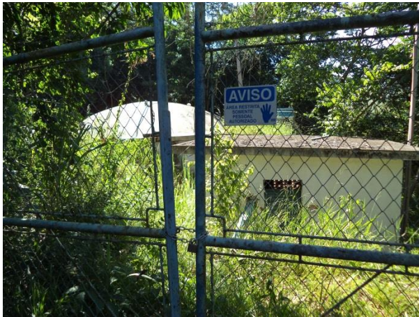
FIGURA 29 – RESERVATÓRIO R1 e EEAT 2 (FONTE: VALLENGE, 2014)
