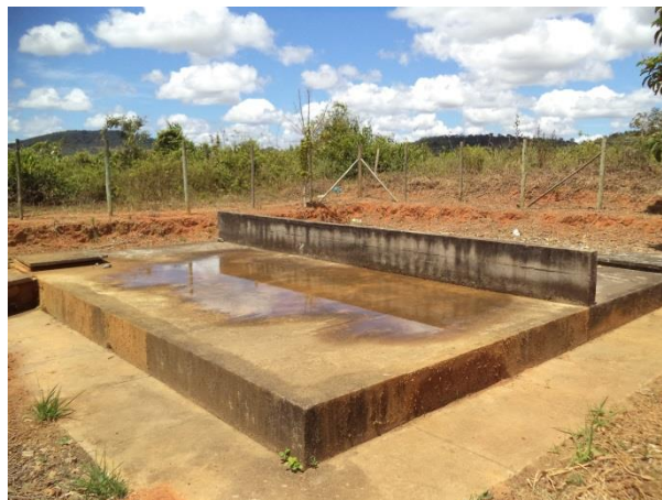
FIGURA 41 – RESERVATÓRIO VISTA ALEGRE (FONTE: VALLENGE, 2014)
