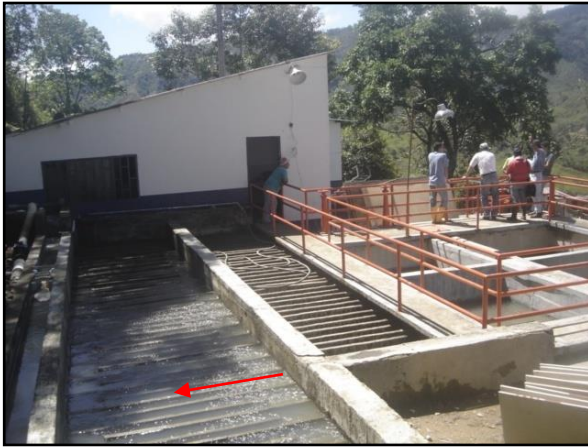
Foto 1. Planta de Tratamiento de aguas Del municipio de Río Blanco.
