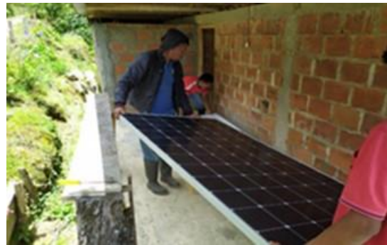
Foto 187. Implementación paneles solares en la emisora comunitaria.
