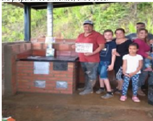
Foto 184. Instalación Estufa Eco Eficiente – Municipio de Jamundí – Fuente: GEOMA.
