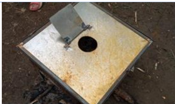
Foto 189. Cámara de distribución de agua.
