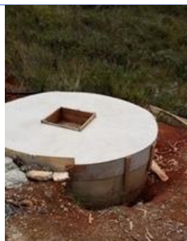
Foto 190. Tanque de almacenamiento de agua de 5 m3.
