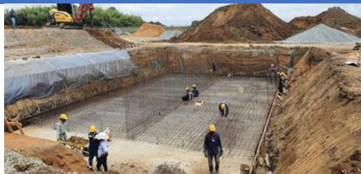
Foto 63. PTAR Yumbo - Tanque contacto de sólidos
