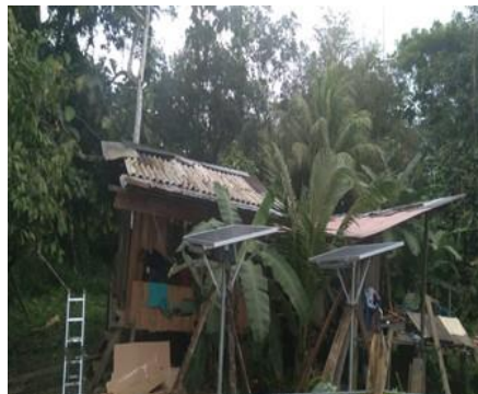
Foto 188. Sistemas fotovoltaicos unifamiliares instalados- Consejo Comunitario de la Comunidad Negra de Cuellar.
