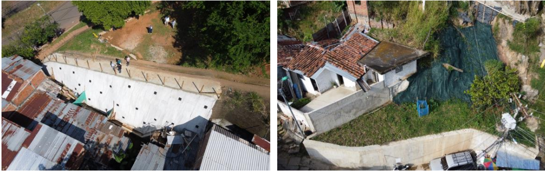
Foto 218. A la izquierda, Talud protegido en Mantocreto y Geodrén Planar Parque Tania. Comuna 20. A la derecha, Muro en concreto reforzado Sector San Francisco Comuna 20. Fuente: CVC, 2020.
