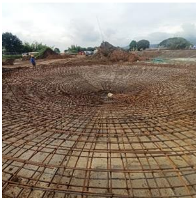
Foto 64. PTAR Yumbo - Digestor
