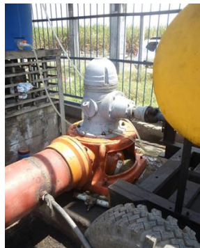
Foto 66. Visitas lectura de contadores – Pozo Vp-381
