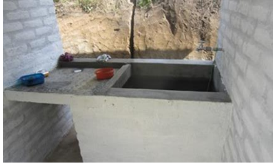
Foto 76. Construcción del sistema de tratamiento de aguas residuales para la comunidad indígena de Guasiruma.
