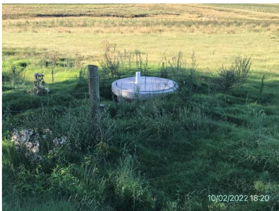
Ilustración 14 – P04, Obrador. Depósito impermeable para aguas servidas.
