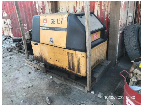
Ilustración 13 – P04, Obrador. Generador eléctrico en funcionamiento sin contención física para prevenir derrames.
