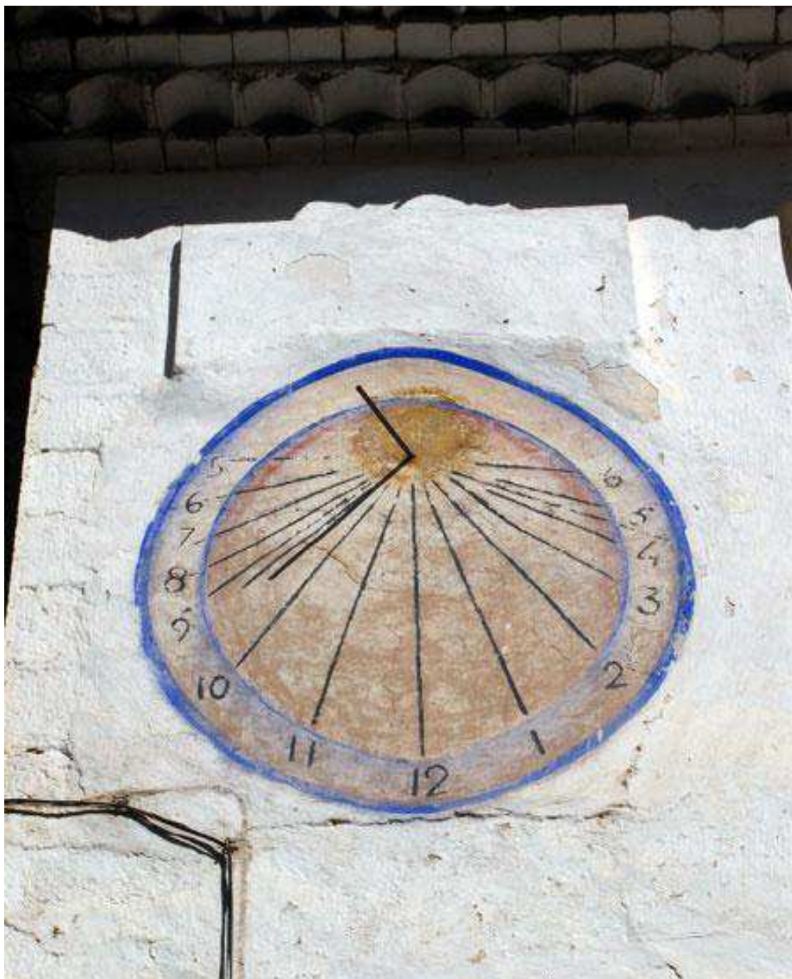
Estado del reloj de sol antes de sacar la piedra de la fachada.
