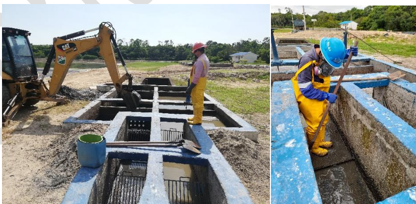
Mantenimiento sistema primario.
