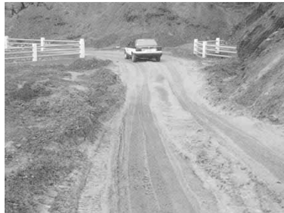
5.- Caminos en mal estado
