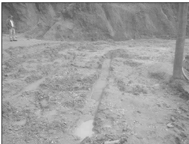
Fotografía 10. Condiciones de los caminos en el municipio en época de lluvias.
