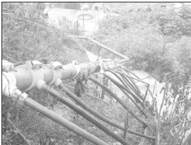
Fotografía 7. Sistema de distribución de agua entubada.
