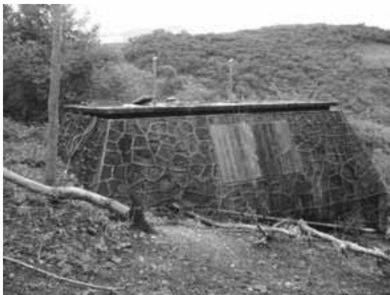
Figura 09. Tanque de almacenamiento de agua potable “La Toma”.
