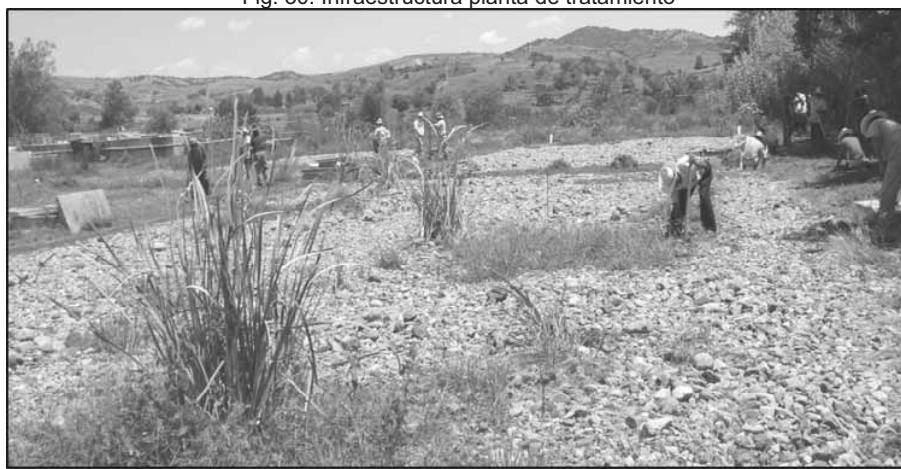
Fig. 30. Infraestructura planta de tratamiento
