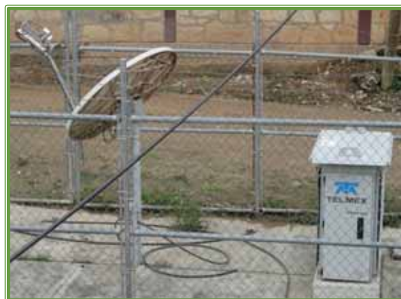
Ilustración 28. Antenas de TELMEX instaladas en las localidades del municipio
