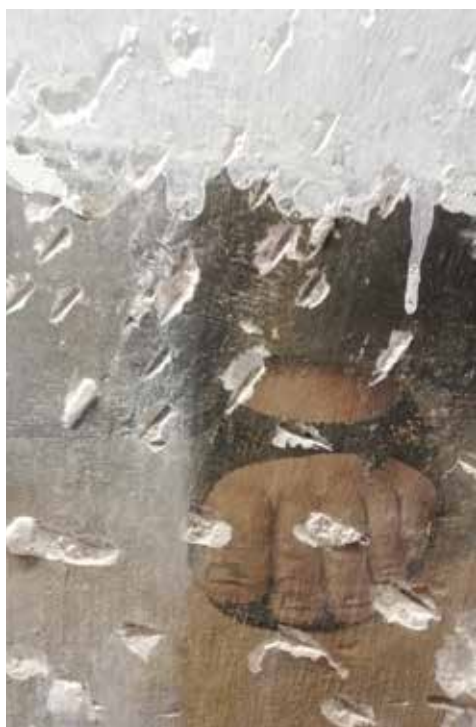
Detalle de la presencia de pintura plástica sobre la decoración.
