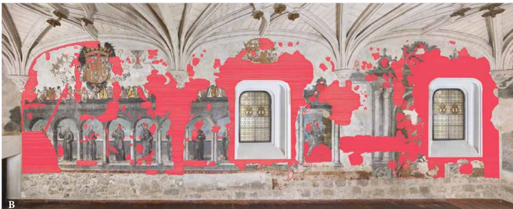
■ Pérdida de morteros de preparación, principales lagunas de enfoscado
