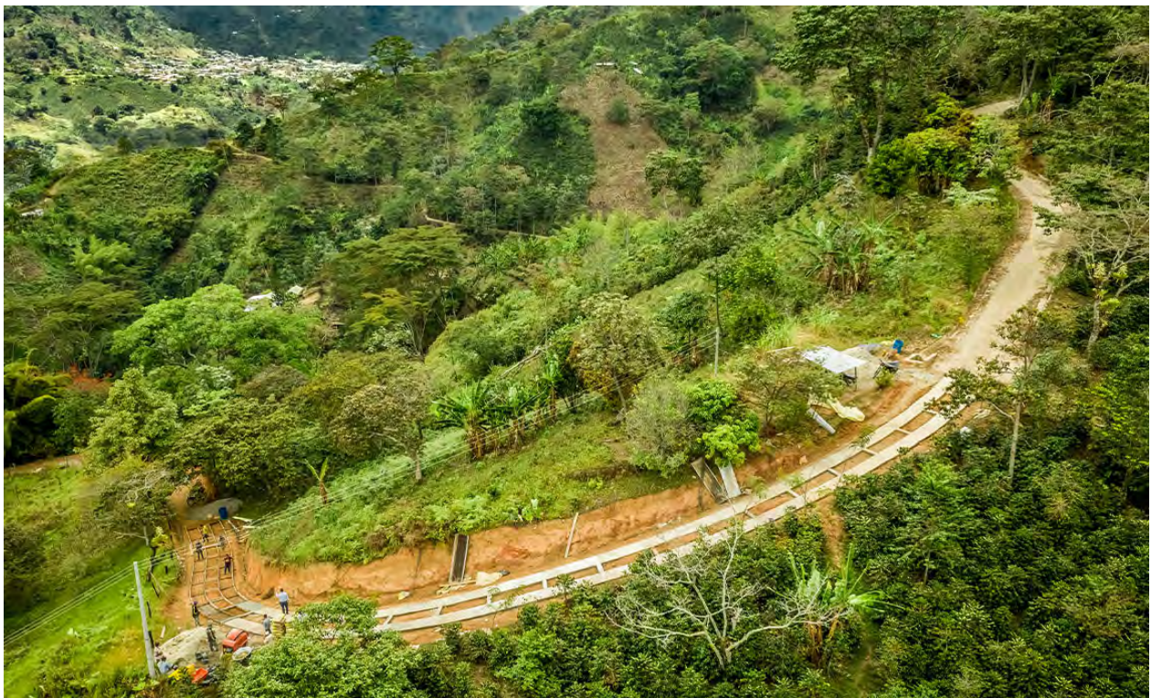
Construimos y mejoramos la infraestructura vial (placa huella) en los territorios donde operamos
