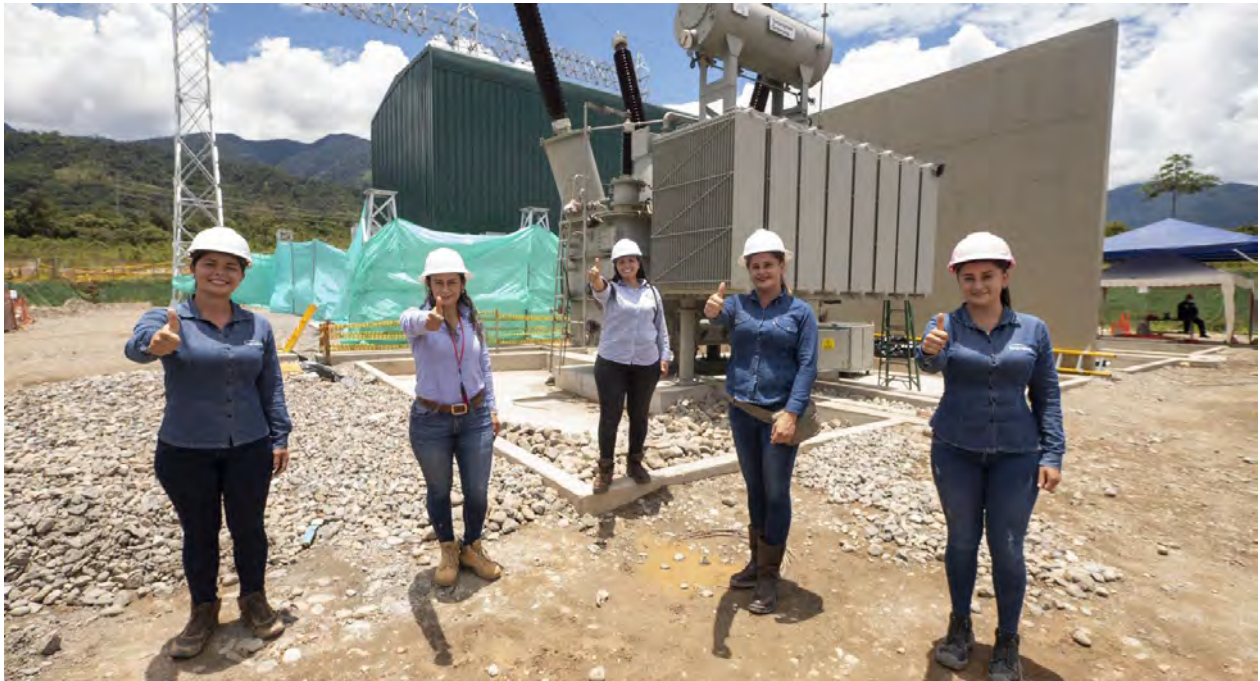
Colaboradoras de GEB en la nueva subestación Mocoa en Putumayo
