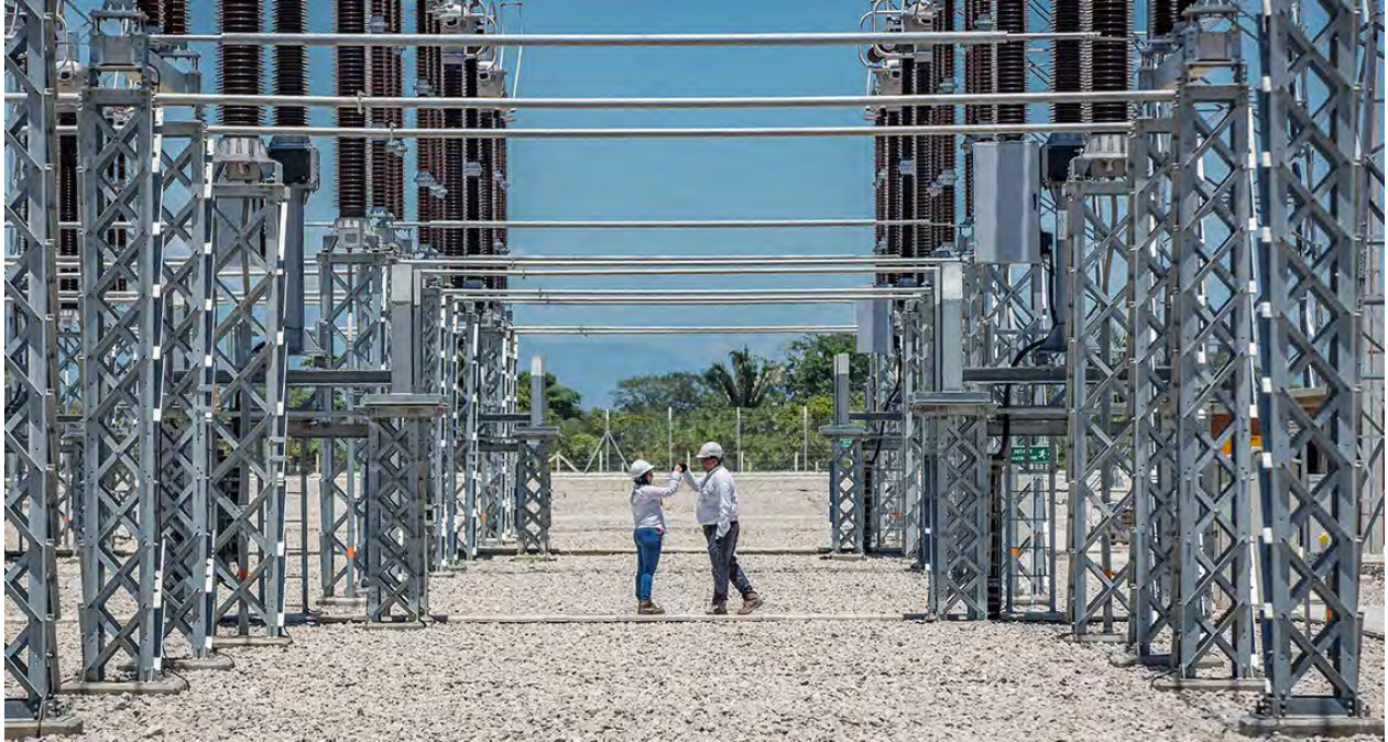
Subestación La Loma en Cesar
