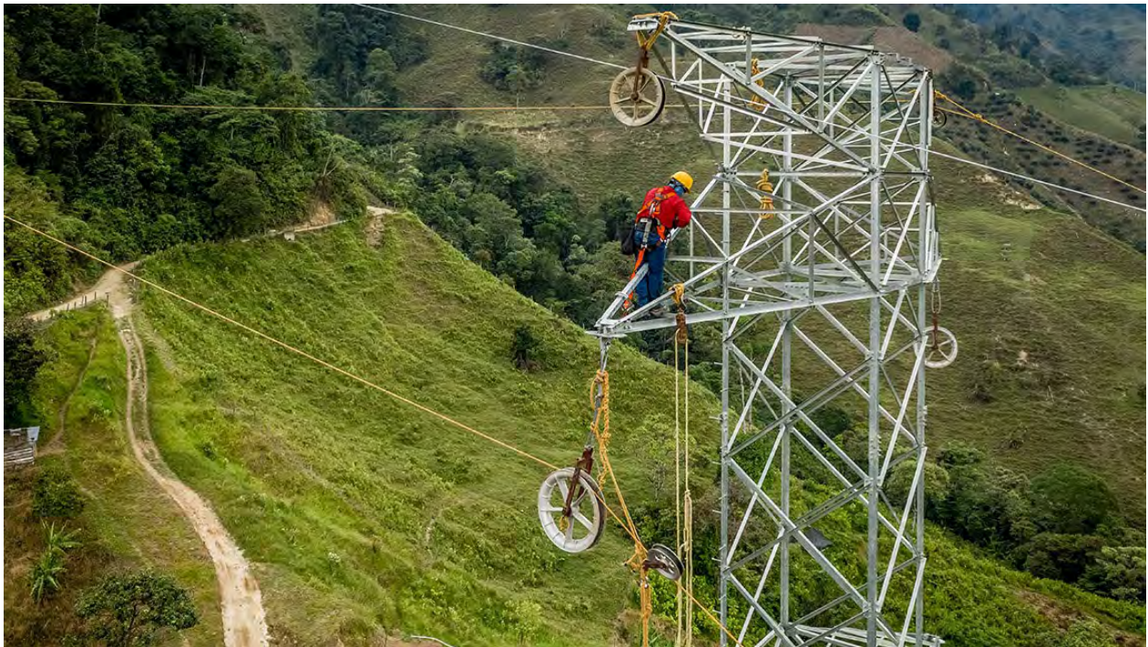
Trabajos de mantenimiento de nuestra infraestructura de transmisión eléctrica
