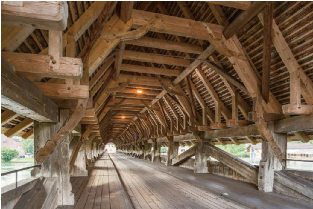
ABB. 239 Wangen a. A. Städtli 24. Aarebrücke. Innenansicht gegen Norden. Über jedem Pfosten ist ein Hauptjoch des liegenden Dachgerüsts aufgebaut. Dabei dienen gebogene Eichenbüge als Streben zwischen der liegenden Stuhlsäule und den Eichenstützen oder dem Kehlbalken. Foto Markus Beyeler, 2017. KDP.
