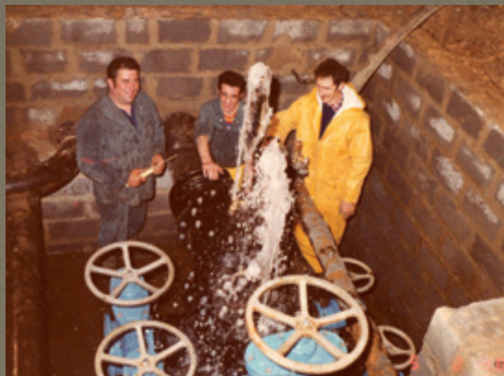
Noeud de vanne de départ de l'adduction du Grand Chemin
