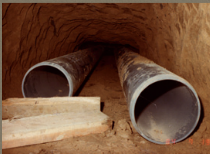
Passage sous la voirie, creusé à la main, sans ouverture de route.
