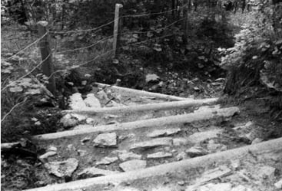
Mit grosser Anstrengung wurde der Alpweg nach Sinzgäu (NW 521) in der Rübimatt instand gestellt: Davon zeugen die Holzschwellen und steinbesetzten Trittflächen der Stufen.
