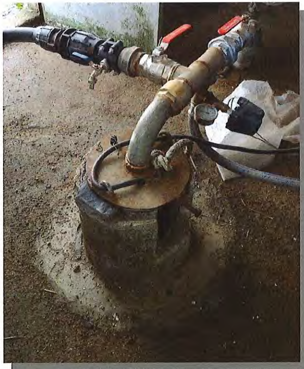
Fotografía n° 2. Brocal del sondeo Tres Palos. Impulsión a la piscina (derecha) y salida exterior, con grifo de muestreo
