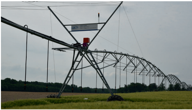
Abb. 3.4.3.4: Kreisberegnungsanlage. Foto: Janina Fuge
