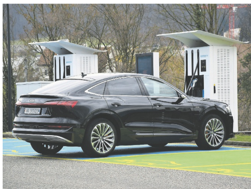
An der A1-Ladestation in Würenlos: Die zweieinhalb Tonnen Gewicht fühlen sich beschwingt an.
