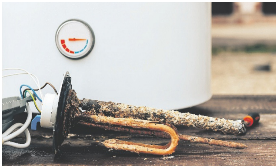
Das Bild zeigt die Kalkbeschichtung auf einem Heizeinsatz, was zu verminderter Wärmeabgabe und erhöhtem Energieverbrauch führt.
