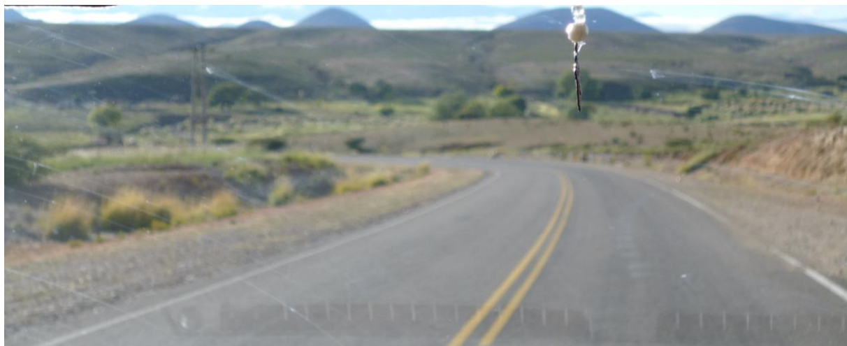
Imagen 27. Estado de la RP5. Camino a Yavi. Pavimento Asfáltico.
