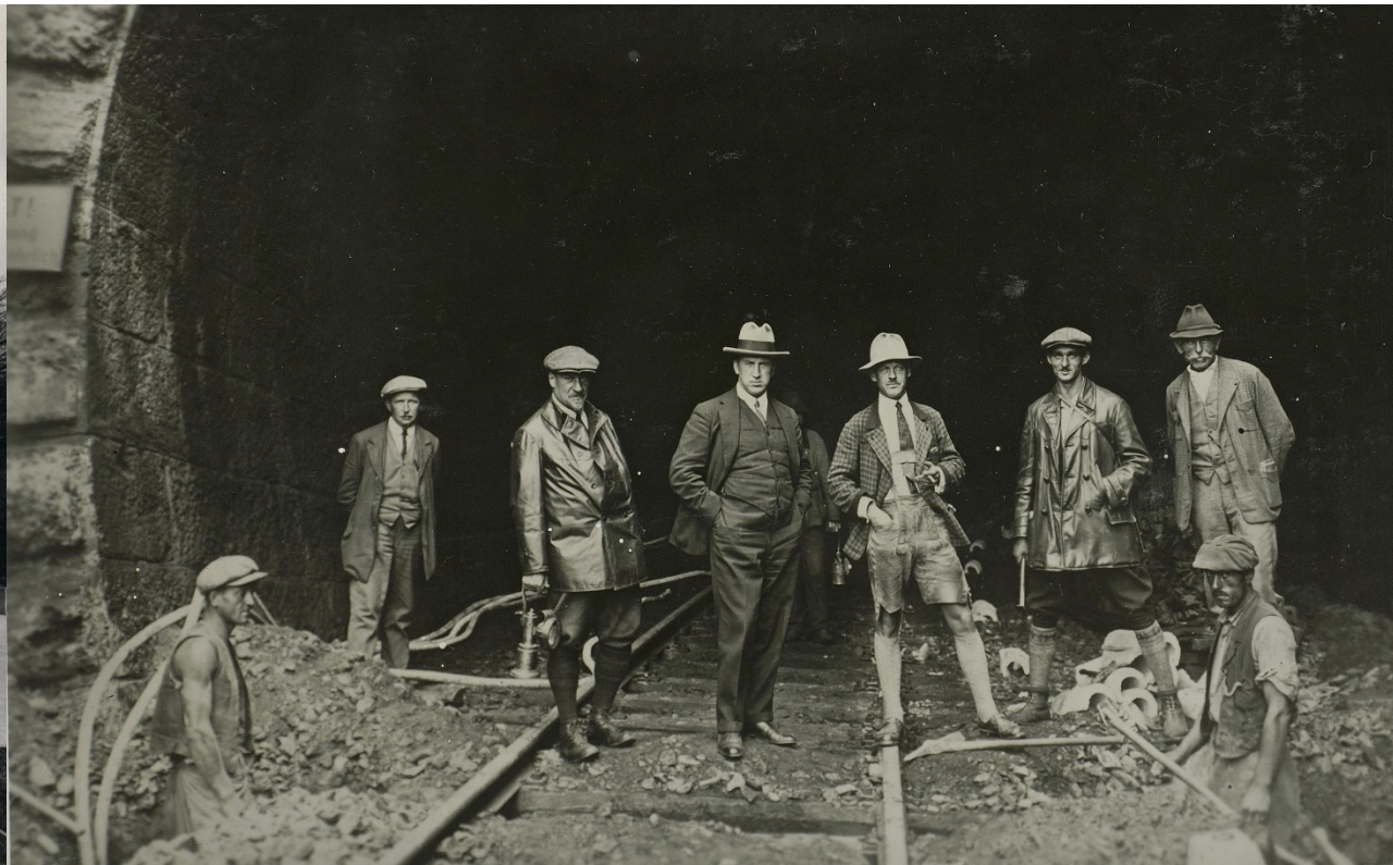
Unbekannt: Bischofshofen – Hüttau, Bahnkabellegung 1928, Zell am See - Salzburg, Ing. A. Spritzer, Aktiengesellschaft für Bauwesen (Ans_05372-162-AL, http://doi.org/10.3932/ethz-a-000095074 )
