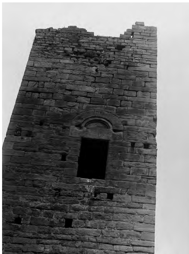
Torre fortificada del castillo de Sala-d'Heures. Detalle. © Fundació Institut Amatller d'Art Hispànic. Arxiu Mas
