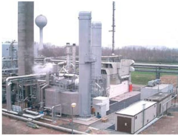
La nouvelle unité de cogénération permet d'économiser 10 à 15% d'énergie primaire
