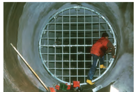
▶ Grobrechen im Zulauf zum Kraftwerk
