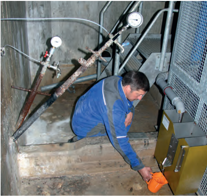
▲ Automatisch gemessene Werte (hier Sickerwasser) werden regelmäßig durch Handmessungen überprüft
