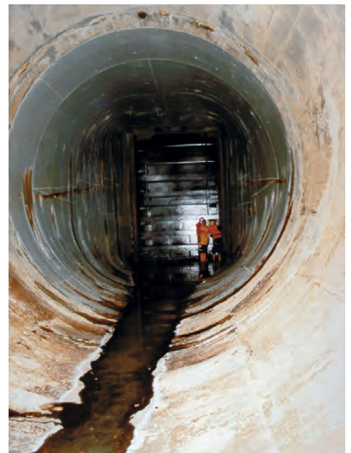
▶ Der Durchfluss des Grundablass- und Triebwasserstollens wird durch Rollschützen gesteuert
