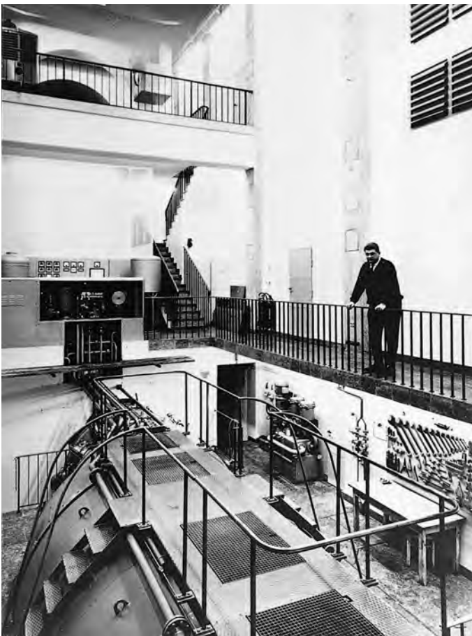
▲ Kraftwerksraum in der Felskaverne mit Turbine, Steuerpult und Zugang
