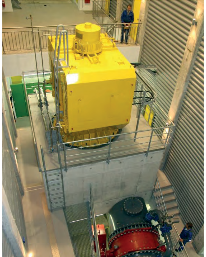
▲ Blick in das erneuerte Kraftwerk
