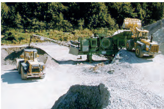
▲ Brechanlage für Dammschüttmaterial
