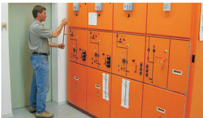
▲ Neue Schaltanlage für den Kraftwerksbetrieb
