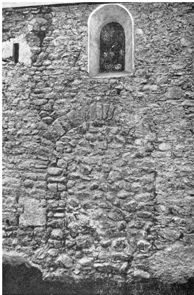
Oberstammheim. Galluskapelle. Westteil der Nordmauer mit zuerst halbwegs, dann vollständig zugemauerter Rundbogenöffnung auf der Nordseite der romanischen Vorhalle. Links oben spätgotische Luke, rechts Rundbogenfenster des 19. Jahrhunderts.
