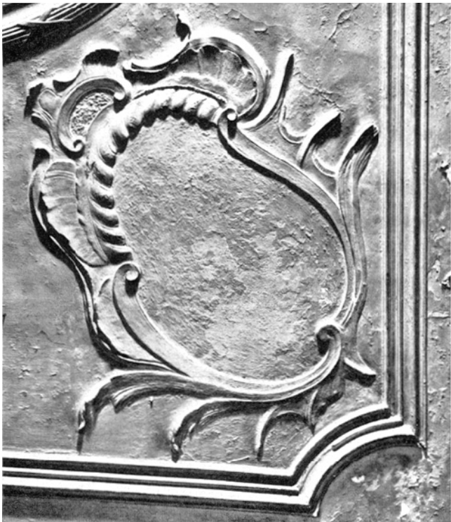
Bülach. Gasthaus «Zum goldenen Kopf». Gothestübli. Details der Deckenstukkaturen von 1762. Alter Zustand, 1964.
